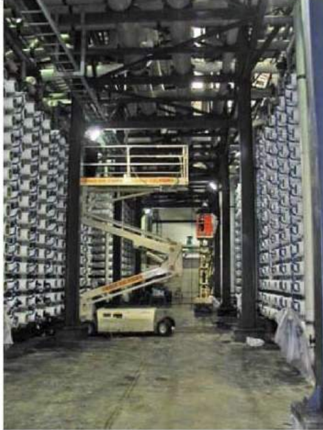
Şekil 7.83 Ashkelon tesisi içten görünüm (Sauvet-Goichon, 2007)
