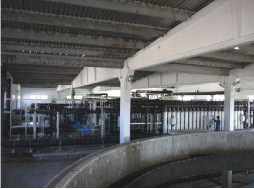
Şekil 7.87 Ankara-Çubuk içme suyu arıtma tesisinde konvansiyonel tesisin alanı içerisinde kurulmuş UF ünitesinin görünümü
