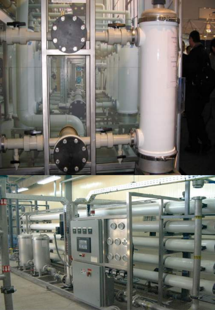
Şekil 7.34 Avşa deniz suyu arıtma tesisi (Babuçu, 2009)
